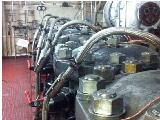
Hauptmaschine: hier sind die doppelten Rohre eher armdick, haben aber die gleiche Funktion wie bei den Hilfsdieseln.
