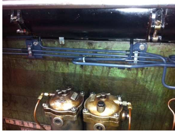
Hilfsdiesel: Die neuen Rohre sind verlegt und passen sich gut in das Gesamtbild ein.
